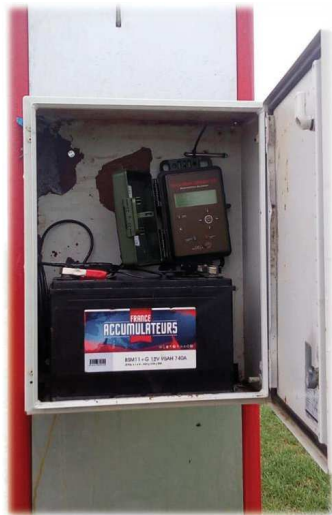
SM4BAT et sa batterie installés dans un caisson de protection en bas du mât de mesure (G. Marchais, Écosphère)
